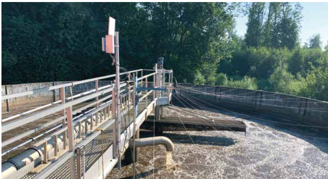
Fig : Utilisation sur le Réacteur SBR à Avenches (Suisse)
