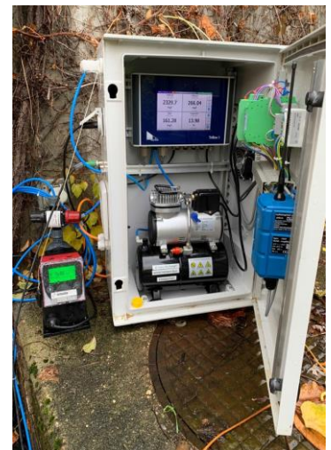
Phosphorsäurereinigung einer UV CSB Sonde in einer Molkerei
