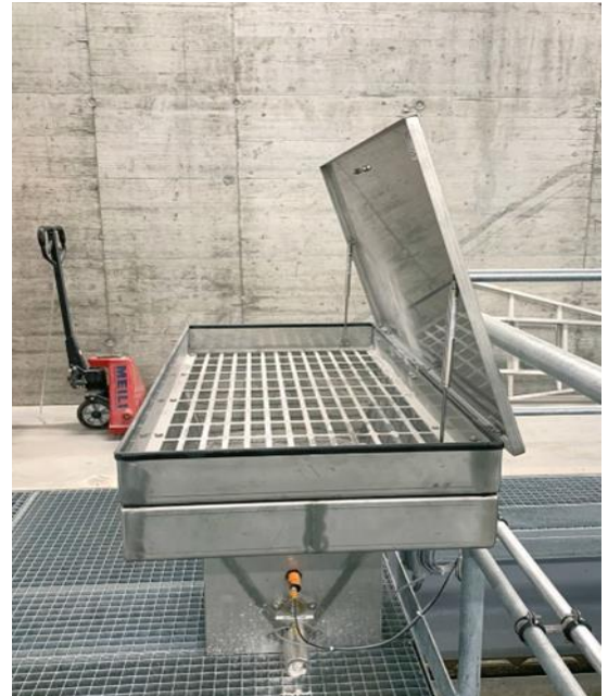
Kreidedosierung mittels Vorlagebehälter und Förderschnecke
